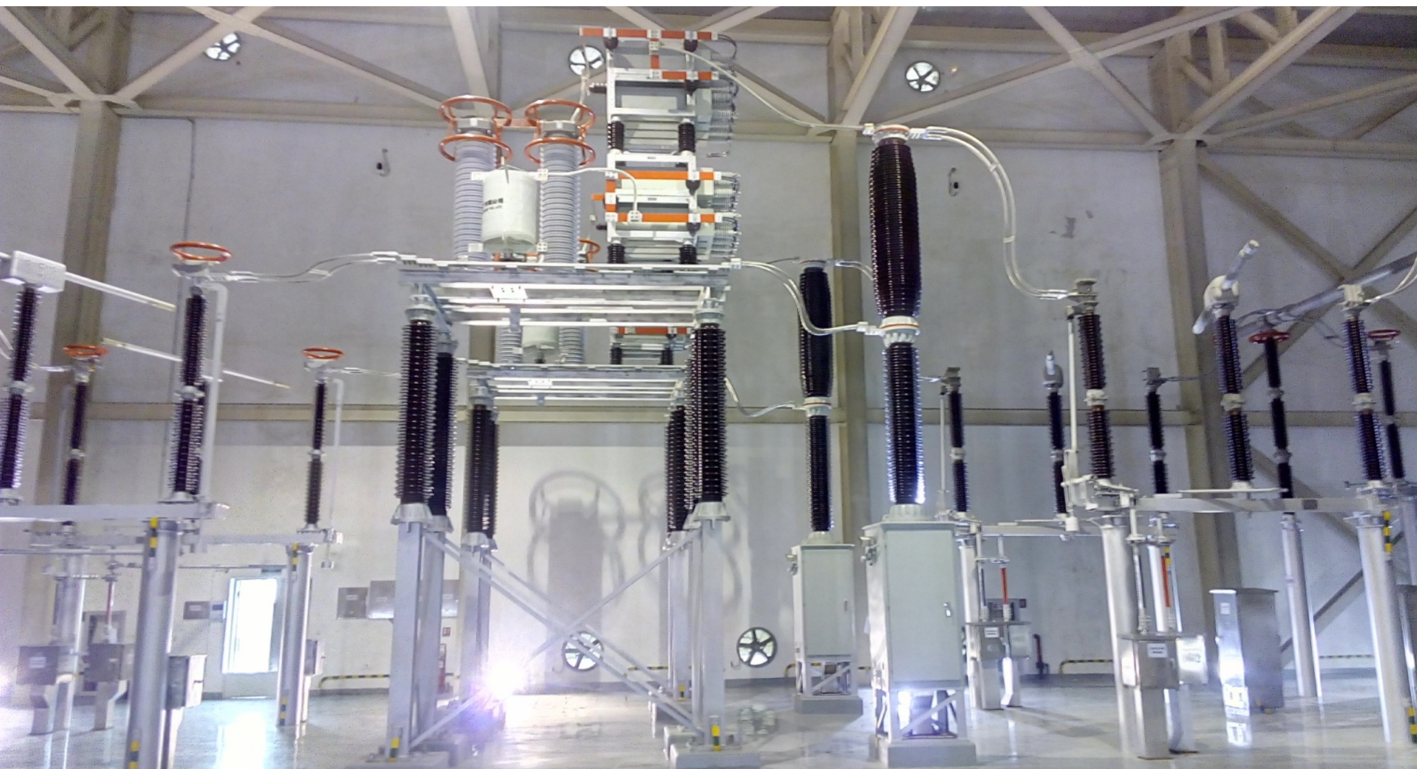
舟山站 DC Transfer Switch
