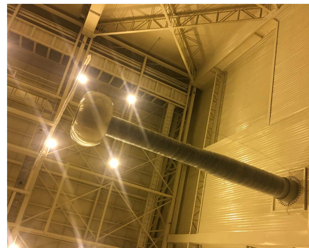
昌吉站 DC Wall Bushings
