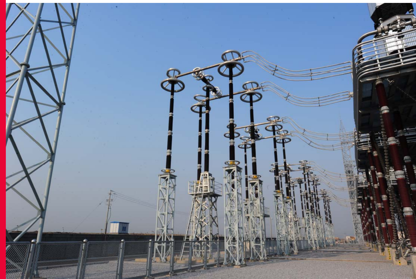
南阳站 DC Bypass Switch
